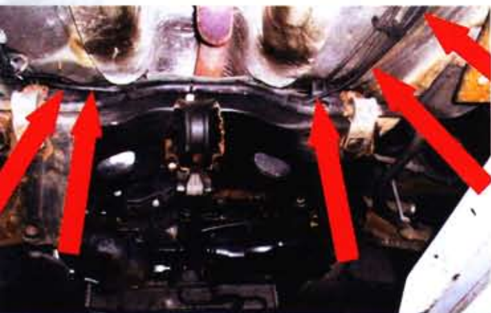
Der kürzeste Weg der Flüssiggasleitung ist nicht der sicherste. In der Nähe der Abgasanlage hat die Gasleitung nichts zu suchen und dass sie nicht an einem beweglichen Stabilisator zu befestigen ist erübrigt sich von selbst.
